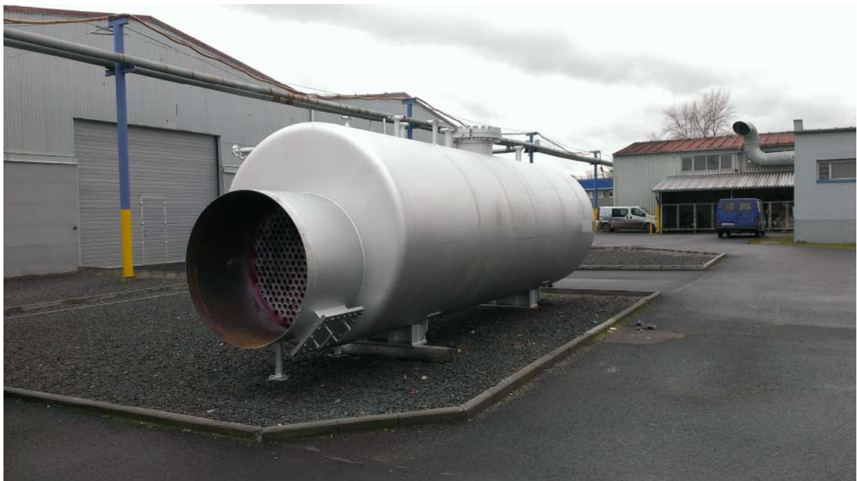
Kotel na odpadní teplo Česká rafinérská, a.s. 11/2013
